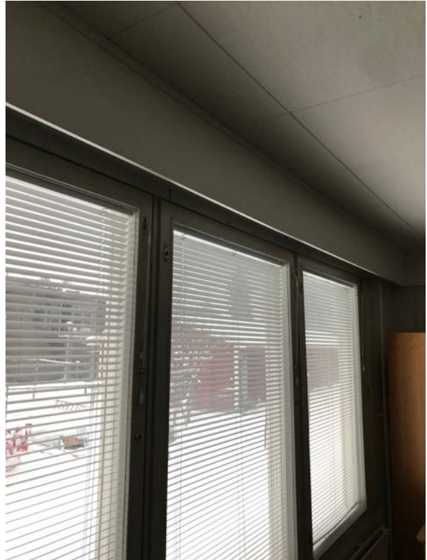
Asunto yksi: korvausilma venttiilit ei havaittu
