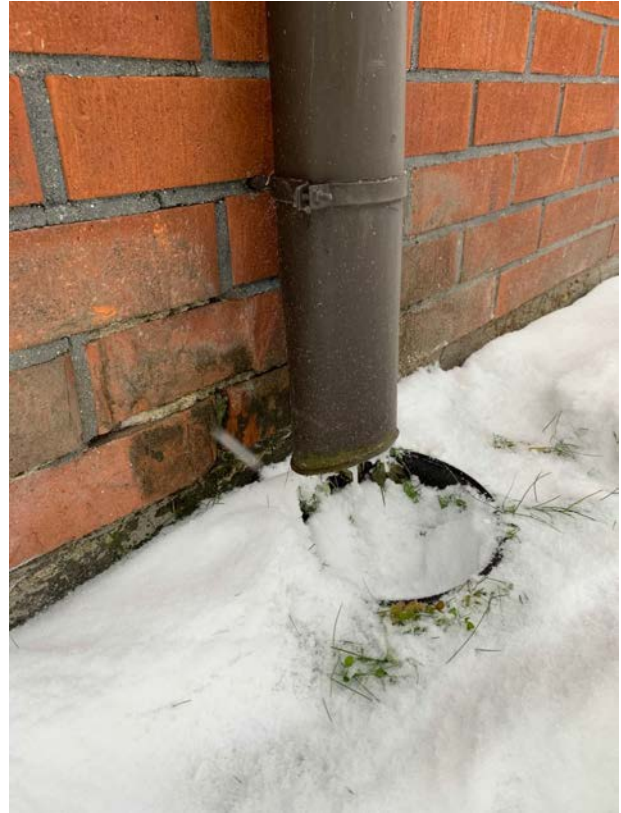
Sadevesisyöksy kastellut ulkoseinän
