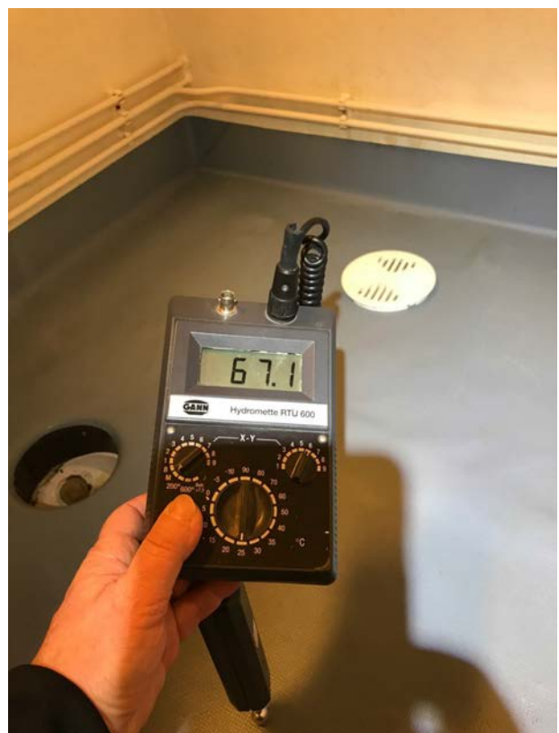
Asunto yksi: alusta rakenteiden kosteuspitoisuutta ei pystytäkään arvioimaan koska pinnoite irti alustastaan
