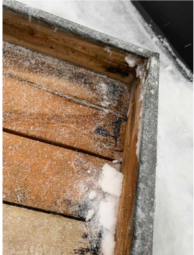
Kattoluukussa havaittavissa kosteusjälkiä
