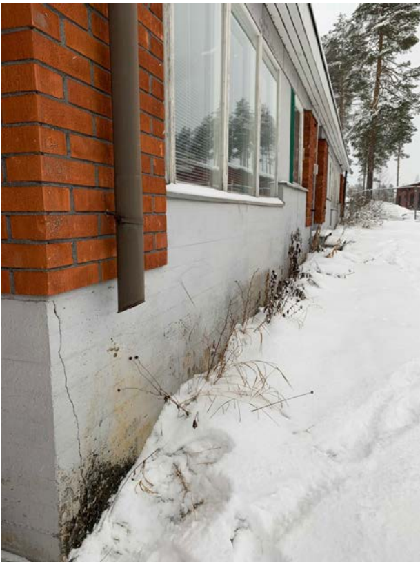
Sadevesisyöky kastellut ulkoseinää. Maanpintaa muotoiltava
