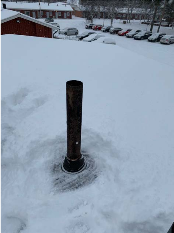
Viemärin tuuletusputki katolla
