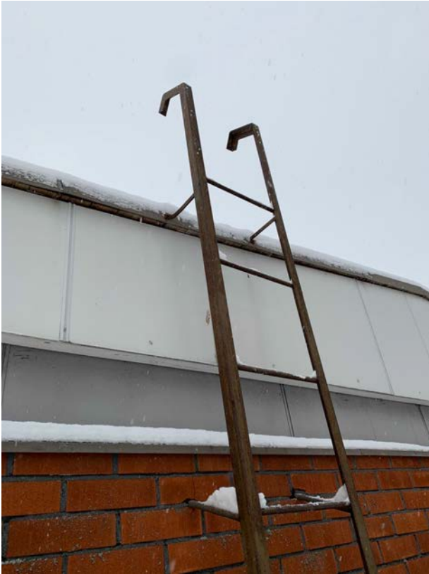
Talotikkaiden yläpäät on irti
