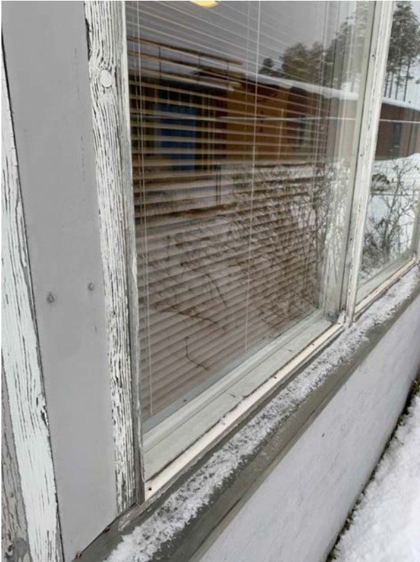
Uloimmat ikkunat joskus uusittu. Huoltomaalauksen tarpeessa
