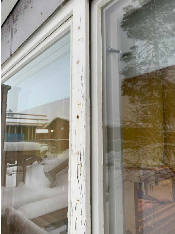
Ikkuna ollut auki pitkään, ikkuna turvonnut puitteesta
