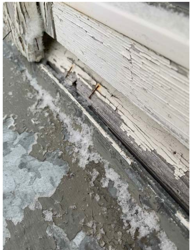
Vesipellin ja ikkuna karmin välissä rakoa, vaurioriski
