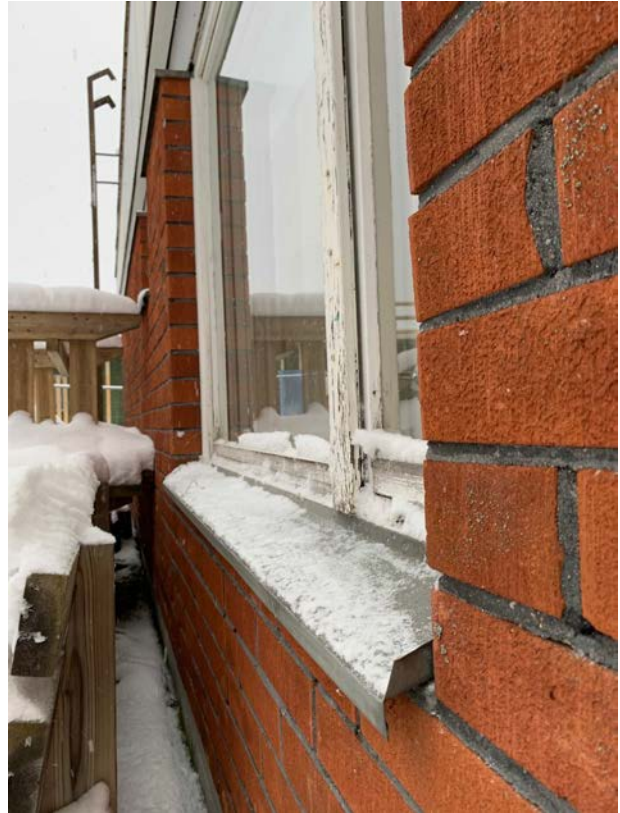
Ikkunapuitteet rapautuneet, maalattava
