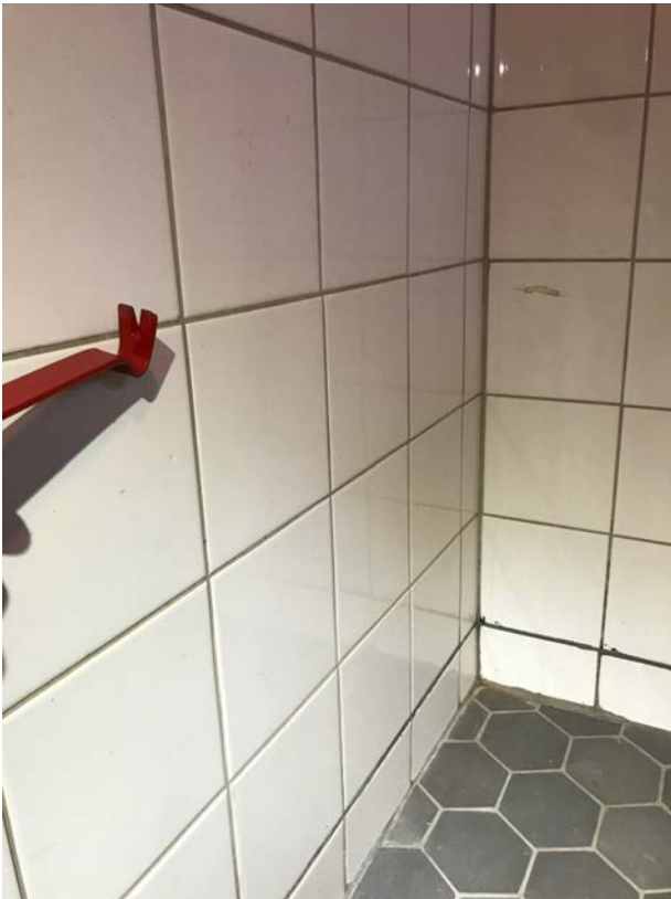
Asunto kaksi: seinä ja lattia laatoituksissa on siellä täällä pohjastaan irtonaisia laattoja, ei isoja pinta-aloja irti alustastaan.
