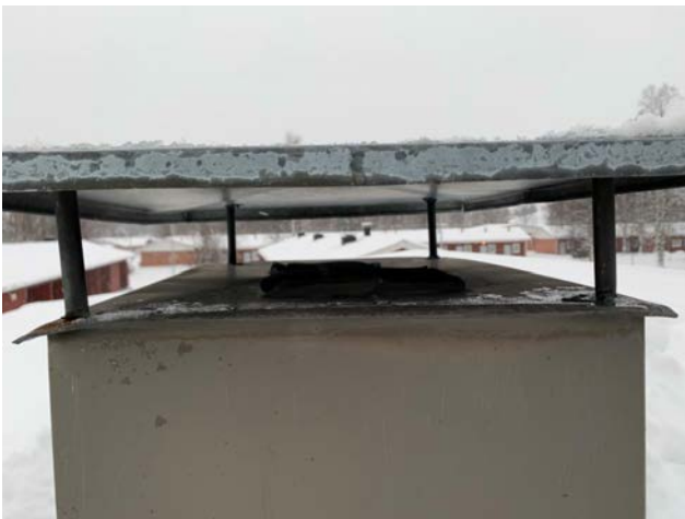
Poistokanavien pellityksen kallistukset ovat hyvät
