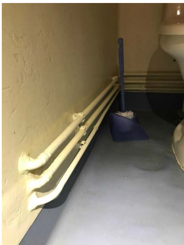
Vesijohtot kuparia, pinnassa
