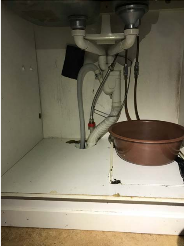
Asunto kaksi, keittiön allaskaappi kuiva. Allaskaapin pohjalla ei ole vuotoallasta
