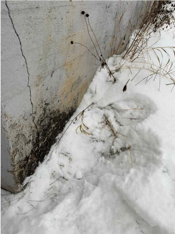
Sokkelissa halkeamaa ja sokkeli kastunut
