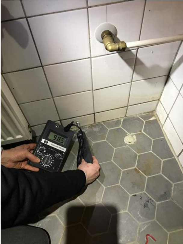
Asunto kaksi: pesuhuoneen ulkoseinän alaosassa, vesipostin alapuolella kosteus koholla
