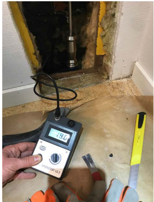
Alaohjauspuun yläpinnan kosteus on koholla
