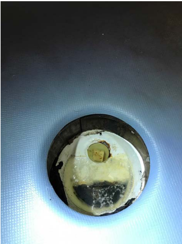
Asunto yksi: pesuhuoneen lattiamatto täysin irti alustastaan. Lattiakaivo valurautaa. Kuparinen korokerengas
