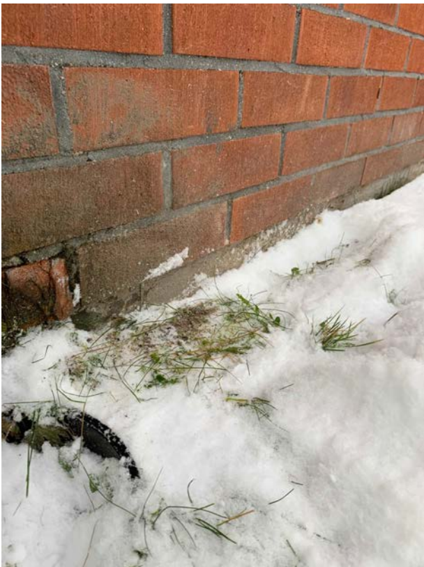
Sadevesisyöksy kastellut ulkoseinän
