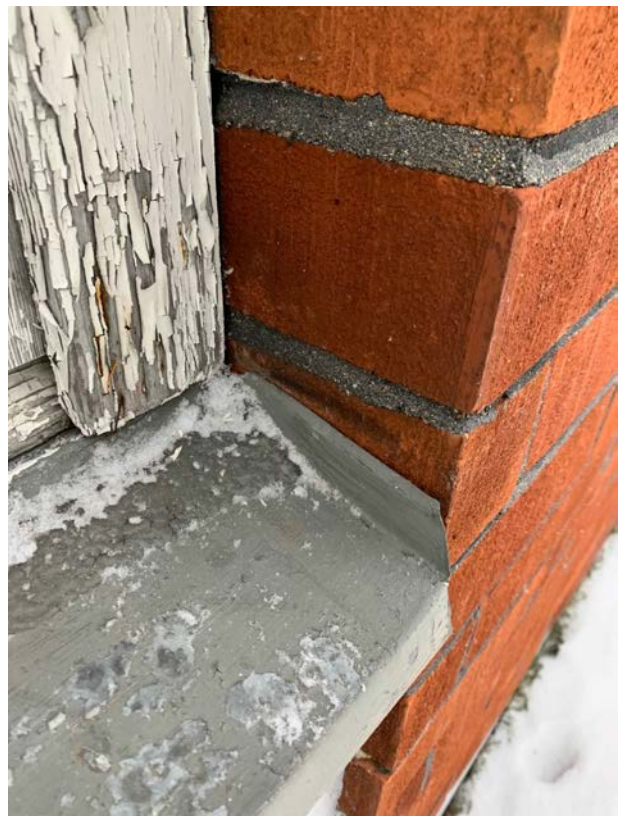
Vesipelti ei ole tiivisti seinää vasten
