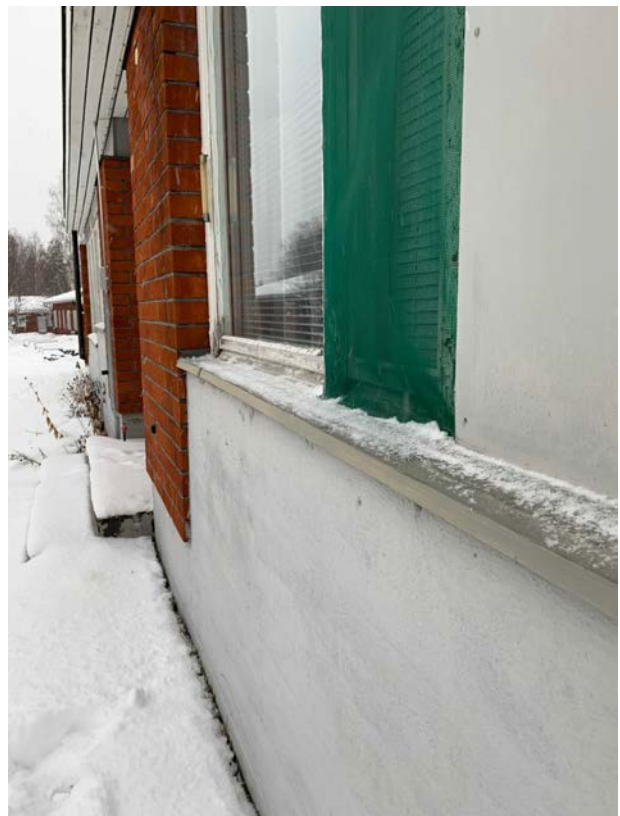
Vesipelti kallistaa ikkunaan päin
