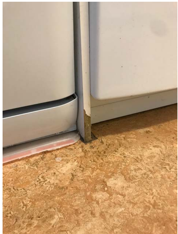
Asunto kaksi: astianpesukoneen kaapin alareunassa kosteus jälkiä
