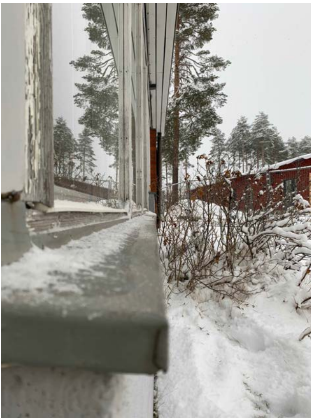
Vesipelti kallistaa ikkunaan päin
