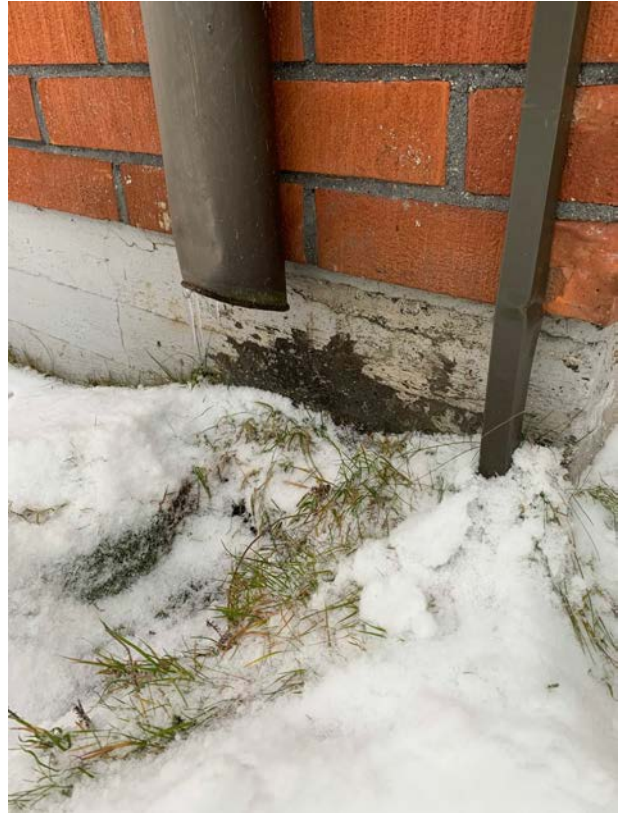
Sadevesisyöky kastellut sokkeliä ja ulkoseinää
