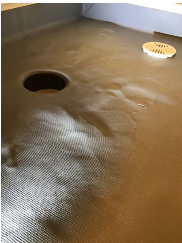
Asunto yksi: pesuhuoneen lattiamatto täysin irti alustastaan
