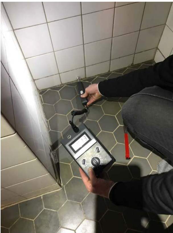
Asunto kaksi: suihkutilat alaosaan kosteus koholla. Ylempänä rakenne on kuiva
